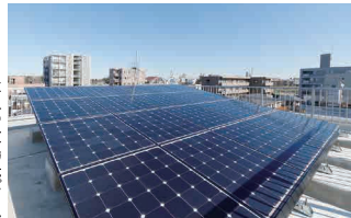
屋上の太陽光パネル
