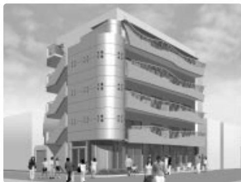
新丸子駅前に建築中の共同ビル (15年7月完成予定) 設計施工 大山組
